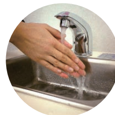
センサー付自動水栓付
